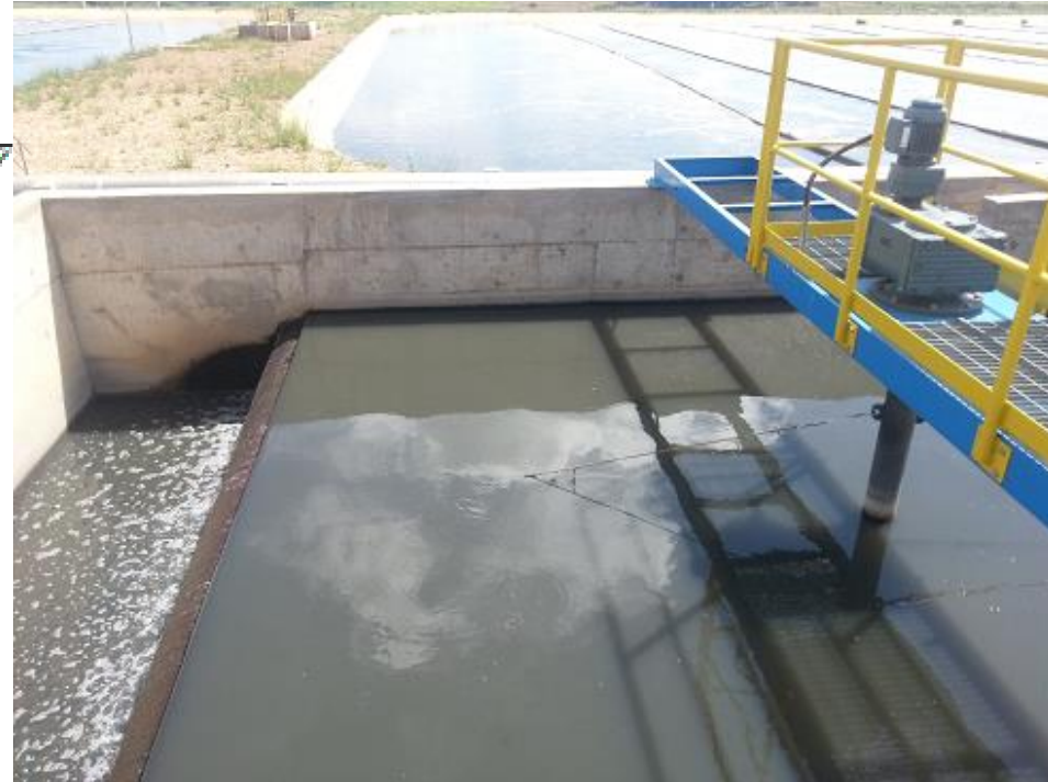
Caixa de areia de limpeza mecanizada
